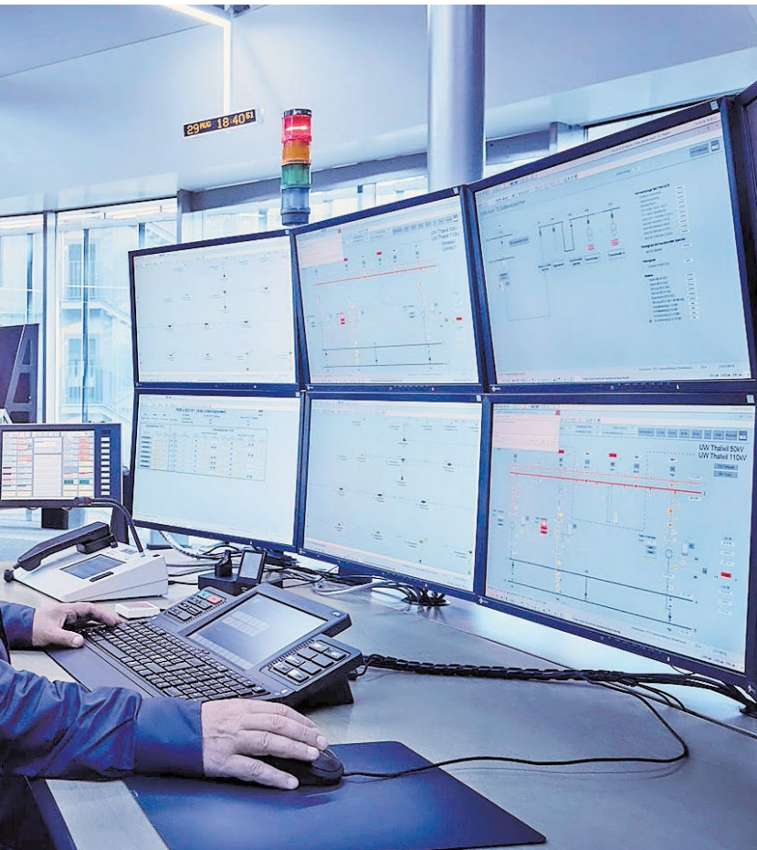
Die Betriebsführungsstelle in Dietikon – eine 24-Stunden-Kommandozentrale – «steuert» die Stromversorgung im Kanton. Bild EKZ
